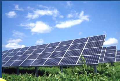
P12～ 太陽光発電システム
